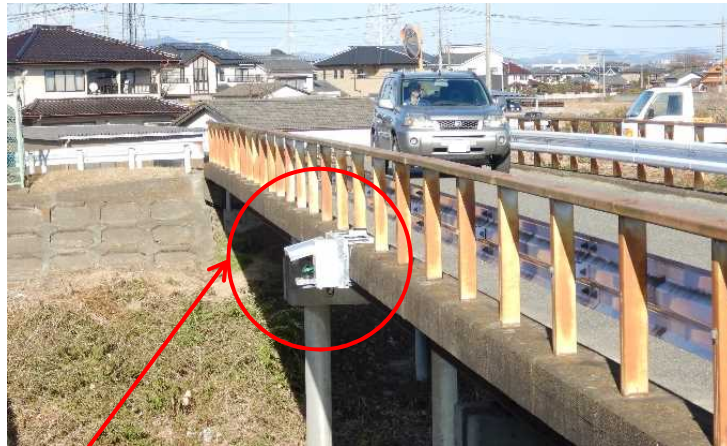
危機管理型水位計（橋梁添架） 超音波式
